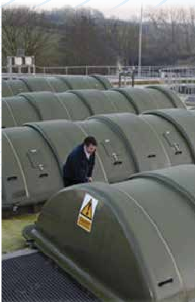
Очисна станція для ОТГ
